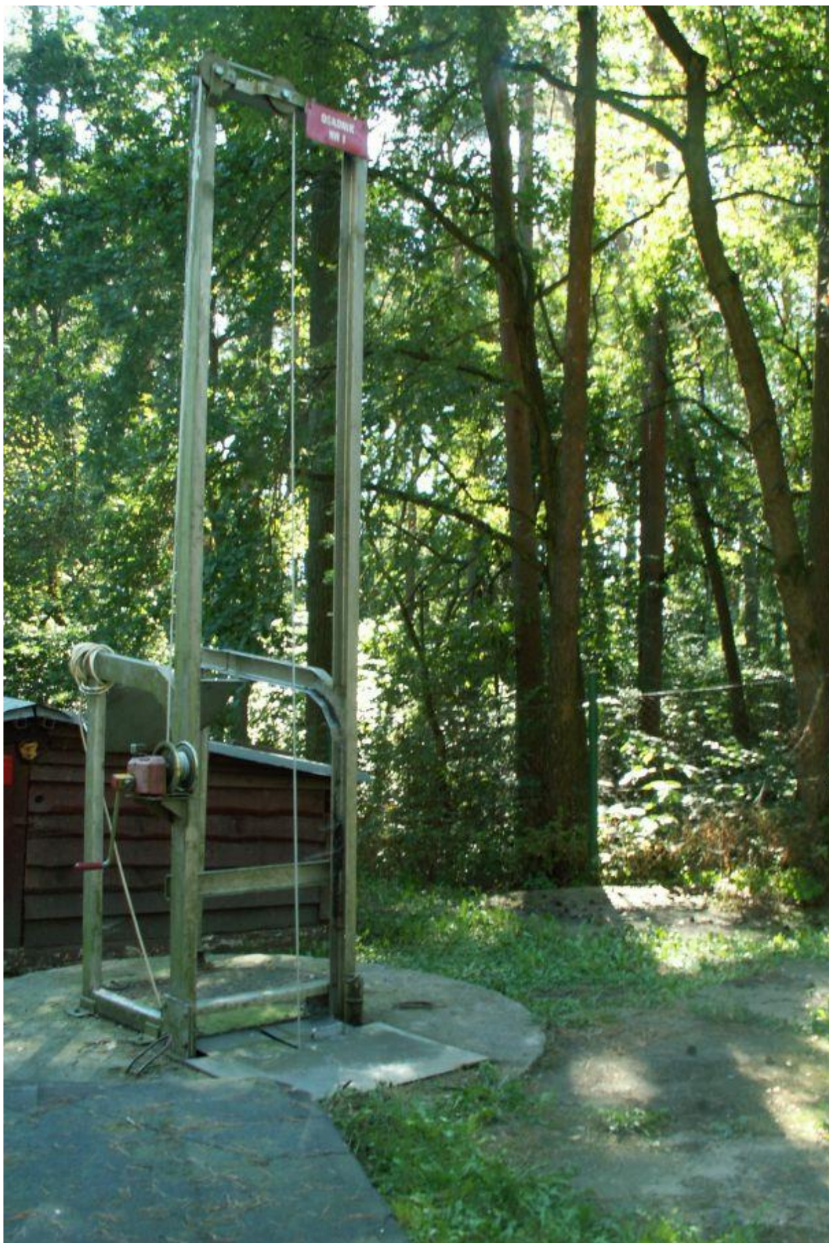
Fot. 2 Krata koszowa – widok zewnętrzny.
