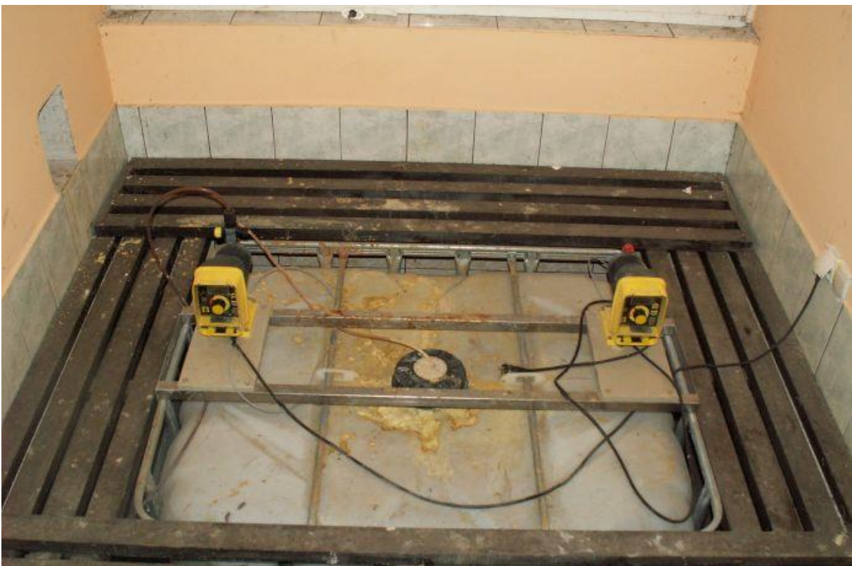
Fot. 10 Stacja dozowania PIX.
