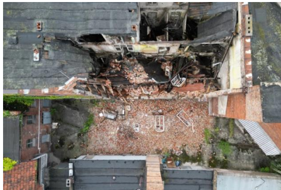
Fot. Widok z góry na zawałoną część budynku
