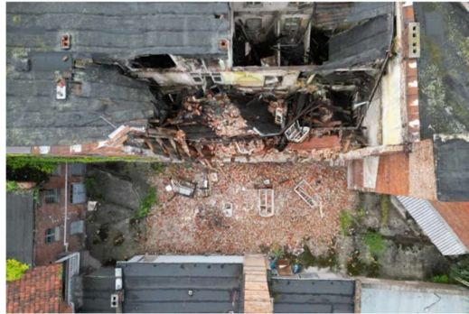
Fot. Widok z góry na zawaloną część budynku
