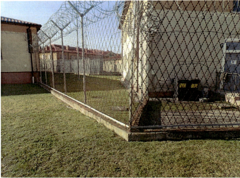
Zdjęcie nr 2: Wygodzenie wewnętrzne przy pawilonie G (do remontu).
