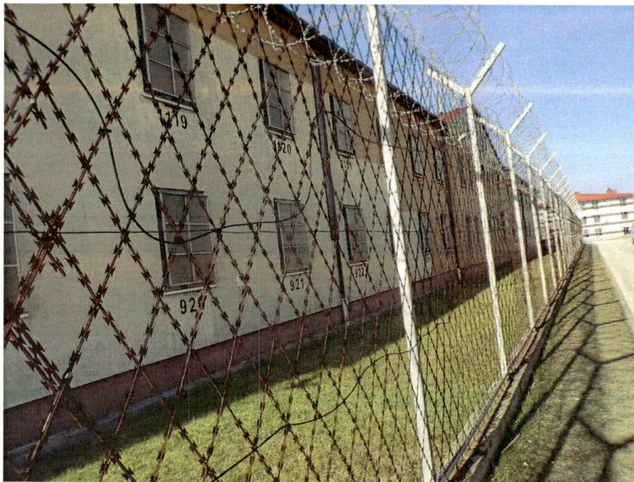
Zdjęcie nr 1: Wygradzenie wewnętrzne przy pawilonie G (do remontu).
